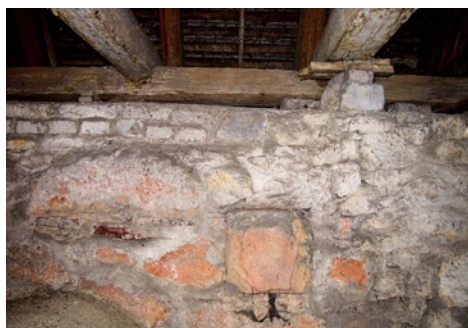
Otisk přízedního trámu nad vnitřní konzolou
